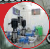
Wasserdruck Steigerungsanlage Nennersdorf
