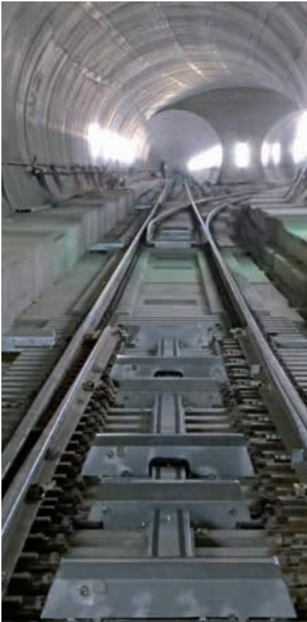
Weichen und Schienensysteme der voestalpine im St.-Gotthard-Bahntunnel
