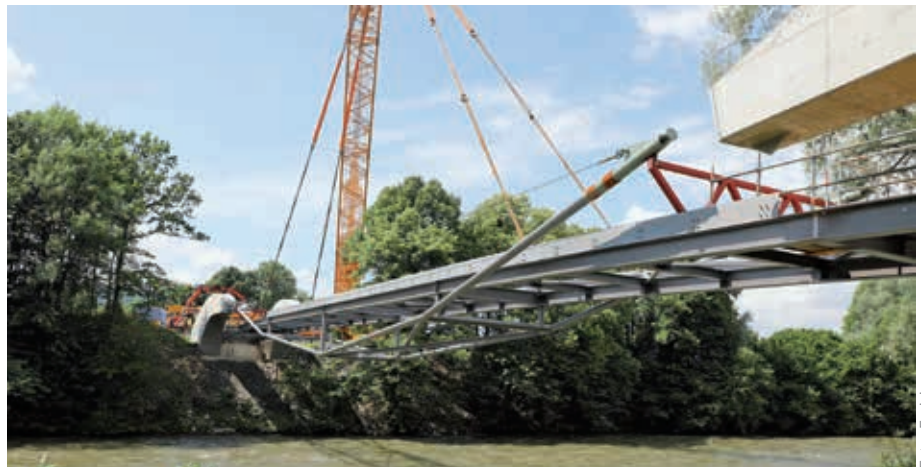
In einer spektakulären Aktion wurde die tonnenschwere Proleberbrücke mit einem Spezialkran eingehängt.
