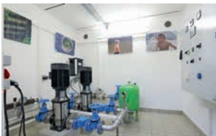
Neue Drucksteigerungsanlage in Nennersdorf
